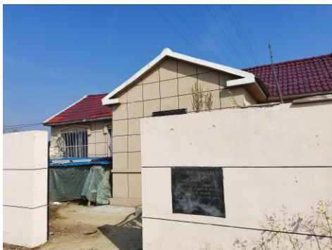
图 2-13 110kV 莱梅线 92#-93#/110kV 莱南线 100#-101#线下尖顶村供水房
