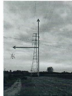
图 2 双回架空 110kV 莱梅线 82#-83#/110kV 莱南线 90#-91#杆塔, 向东侧衰减
