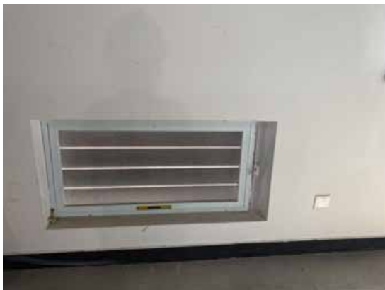
图6-5 110kV 配电室通风
