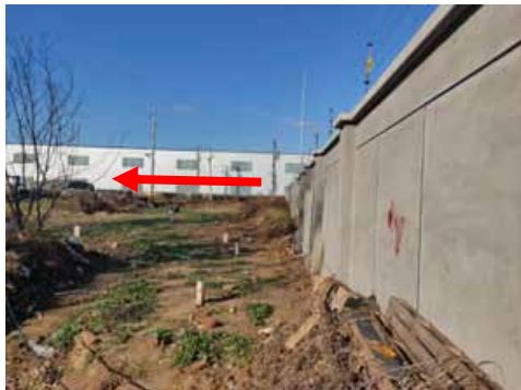
图 4-5 汇泉 110kV 变电站西侧
