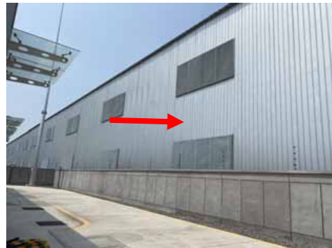
图 4-6 汇泉 110kV 变电站北侧
